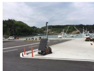
▲無燈漁港に設置された街灯
