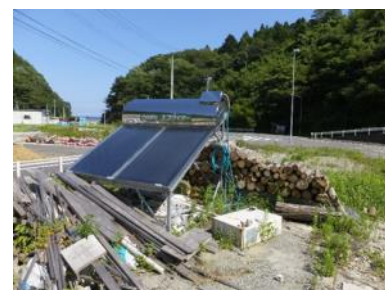
▲太陽熱温水器(石巻市)
